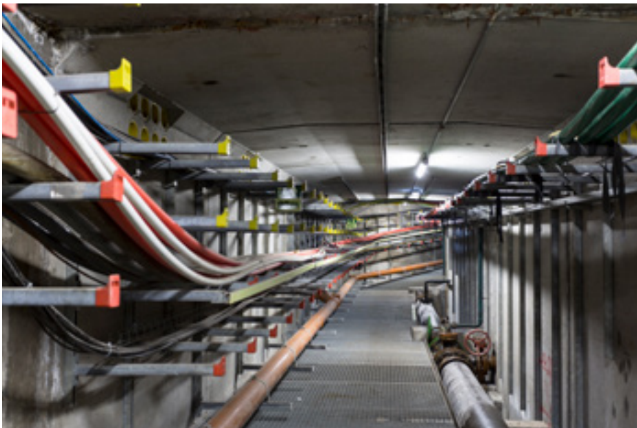
Belysningen gir god synlighet og oversikt over alle installasjoner.
